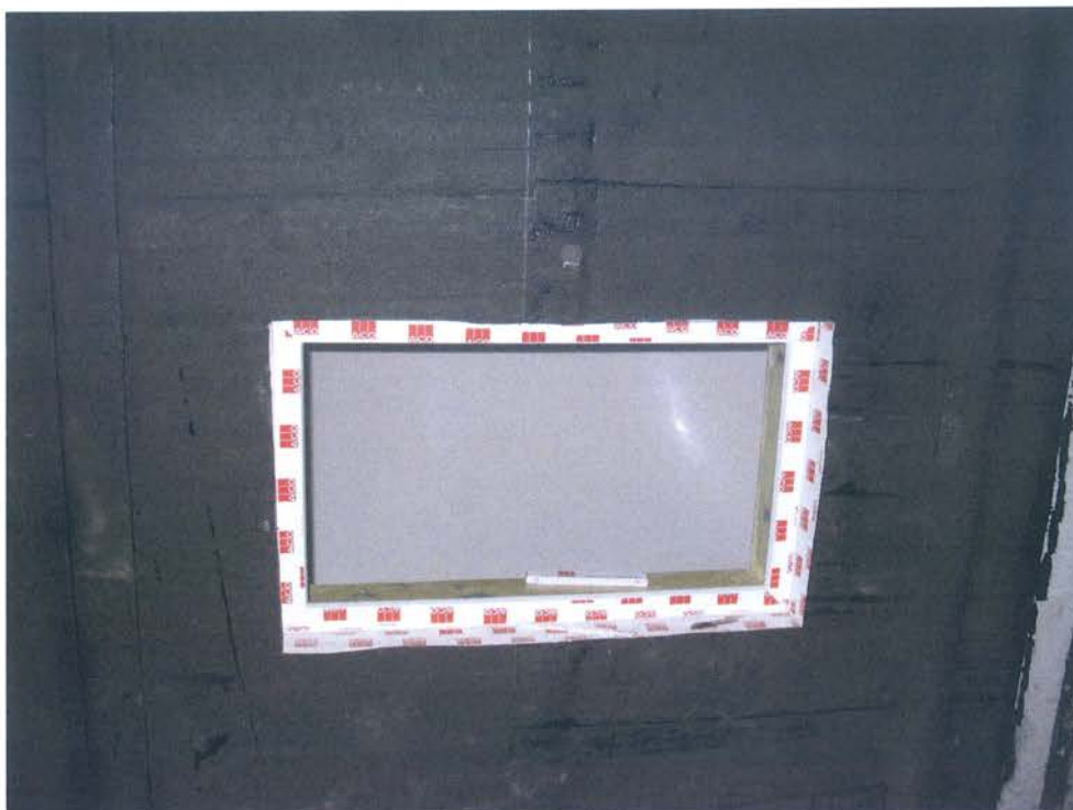
Bild 16: Auf die Versuchswand applizierte Bitumenschweißbahn vor der Befestigung der Montageplatte ACO Therm Block
