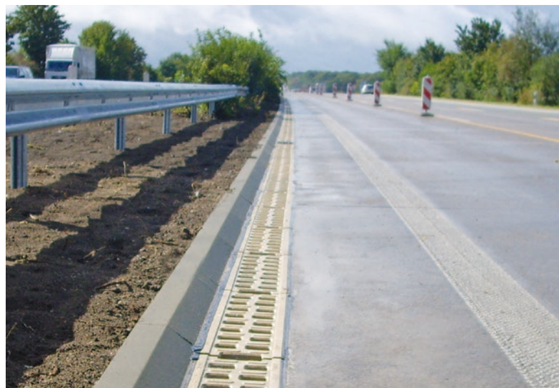
bisher: Entwässerung über Rinne + Betonboard
