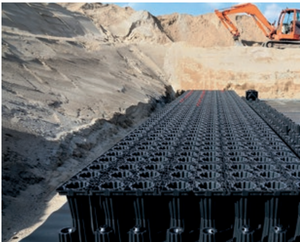
Die Säulenstruktur gewährt eine einfache Inspektion und Reinigung der gesamten Anlage (Löschwasserspeicher wehrtechnische Dienststelle in Eckernförde)
