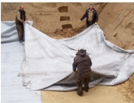
Nach Erstellung des ebenen, stein- und gefällefreien Planums wird die Baugrube mit einem Filtervlies ausgelegt
