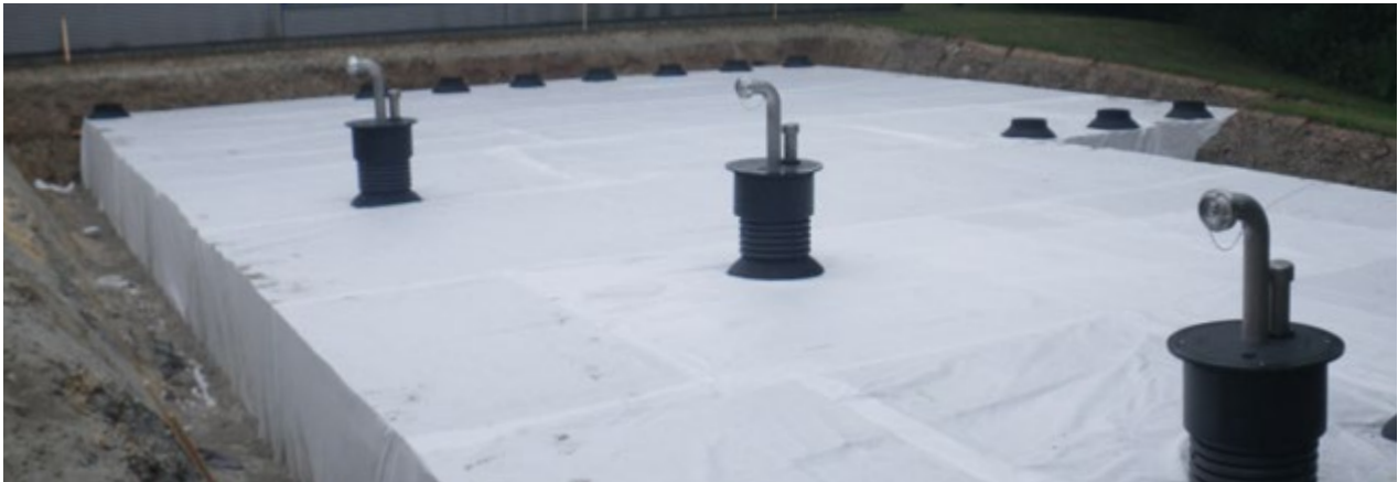
Löschwasserbevorratung nach DIN 14230 (2012), Evoqua Günzburg, 2014
