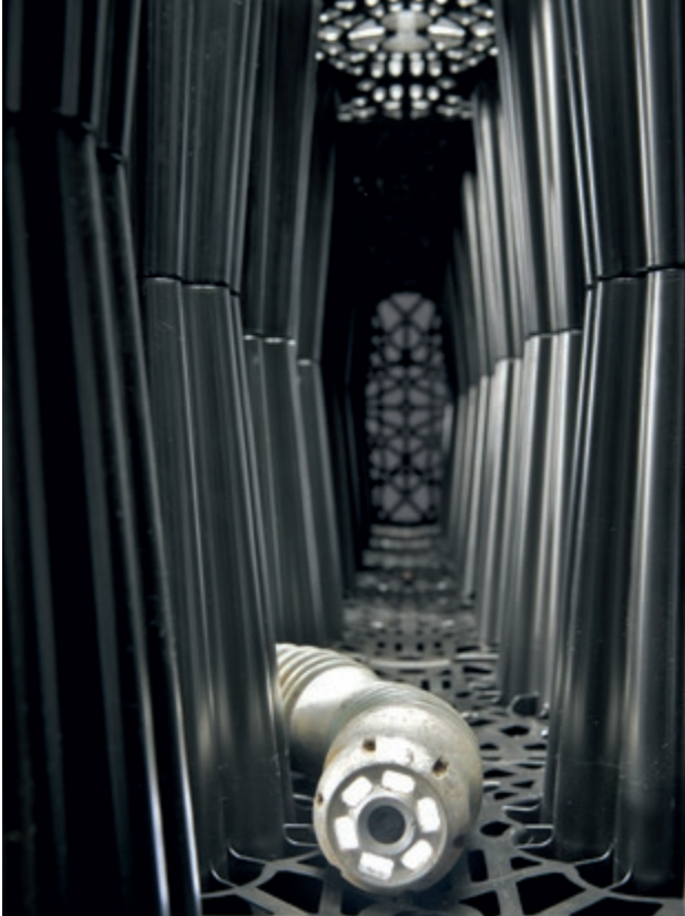
Schiebbare Inspektionskameras können einfach im Rigolensystem eingesetzt werden
