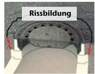
Durch Schwingungen erzeugte Risse an herkömmlichen Schachtabdeckungen
