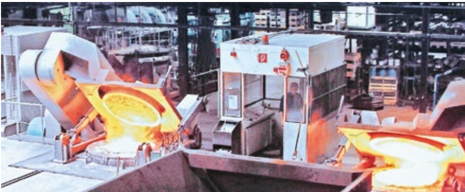
Moderne Mittelfrequenz-Induktions-Schmelzöfen, ACO Kaiserslautern
