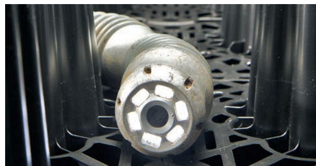
Schiebekamera, Reinigungsgerät mit Spülkopf
